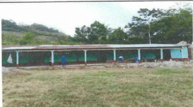
Foto 1: Muestra el entechado a sustituirlo.
