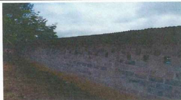
Foto 2: Muestra las 3 aulas a cambiar el entechado.
