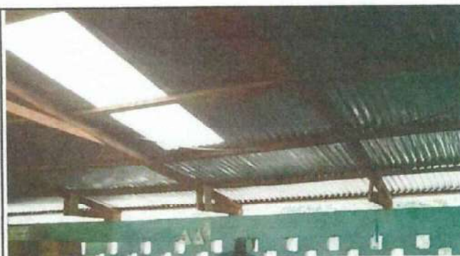
Foto 4: Muestra la madera a cambiarla por estructura metálica.
