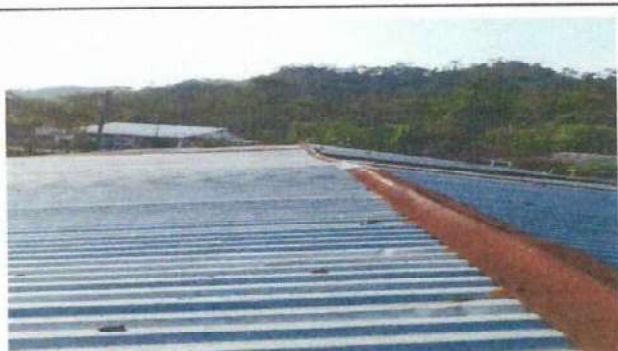
Foto 3: Muestra el estado actual del entechado.
